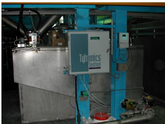
Suivi de fabrication Soude / Carbonate
